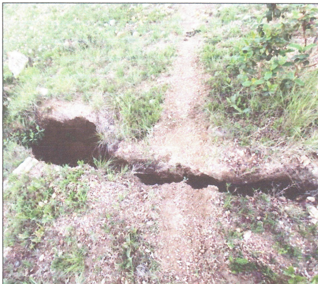
Fig. 7 – Trilha passando por processo erosivo pré-existente. Coord.: -20°31'9.30"S -45°55'53.00"O
